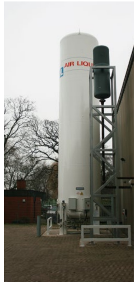
Der Außentank neben der Halle
